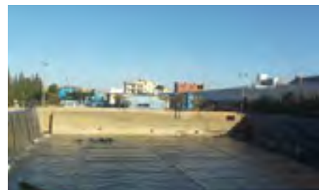
Usine de dessalement de SOUSSE (Tunisie) Desalination plant of SOUSSE (Tunisia)
