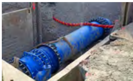
Amélioration du réseau urbain de Bissau (Guinée Bissau) / Improvement of Bissau's urban network (Guinea Bissau)
